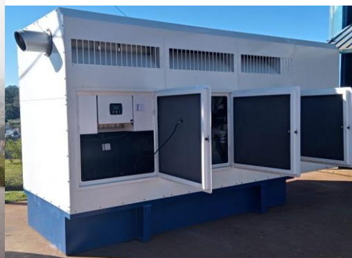
GRUPO MOTO GERADOTR 750 KVA
