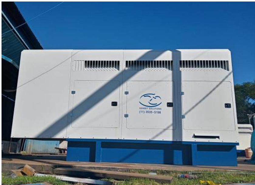
GRUPO MOTO GERADOTR 750 KVA
