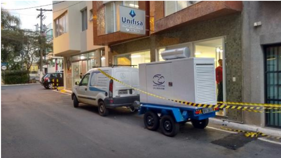
GRUPO GERADOR MONTADO EM CARRETA RODOVIARIA
