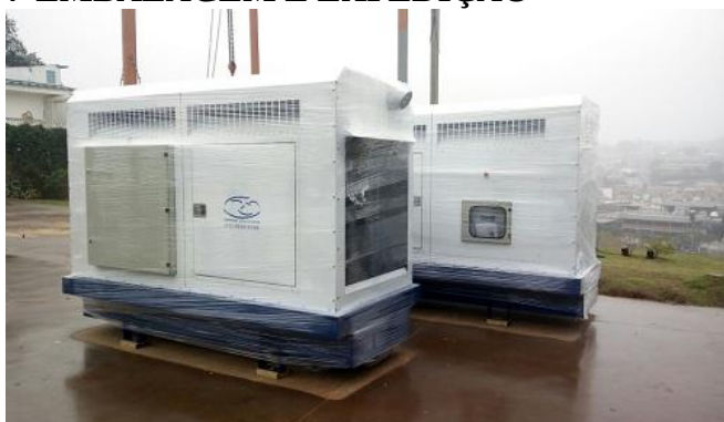
GRUPO MOTO GERADORT 500 KVA
